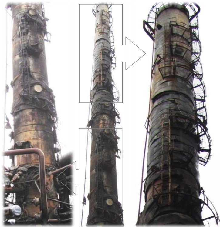
Рис. 2. Ректификационная колонна после аварии
