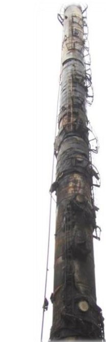
Рис. 2. Колонна после аварии
